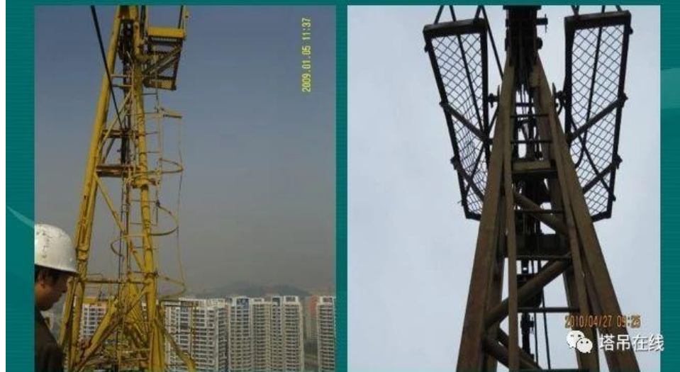
3.5.2 塔帽及驾驶室隐患图片
