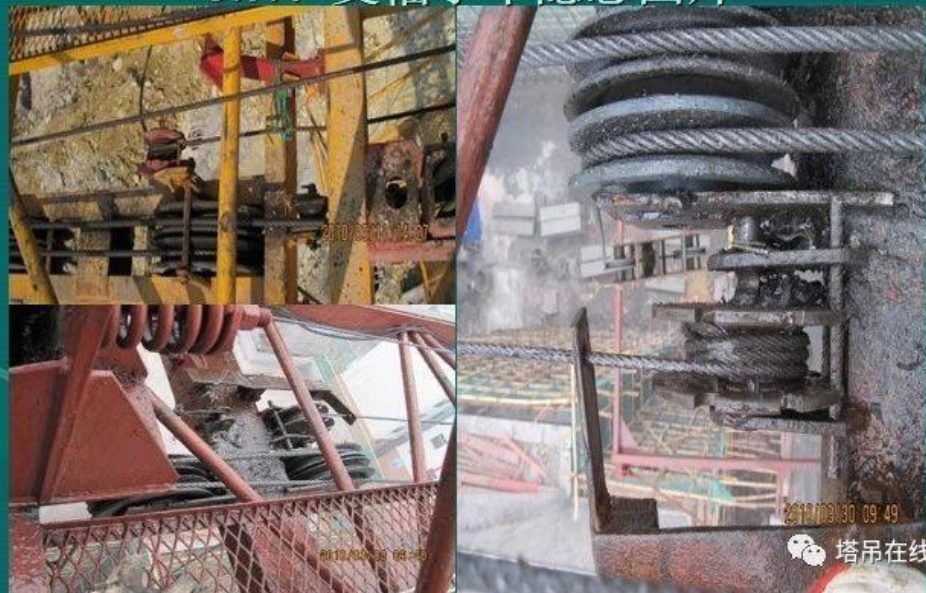
3.7.4 变幅小车隐患图片
