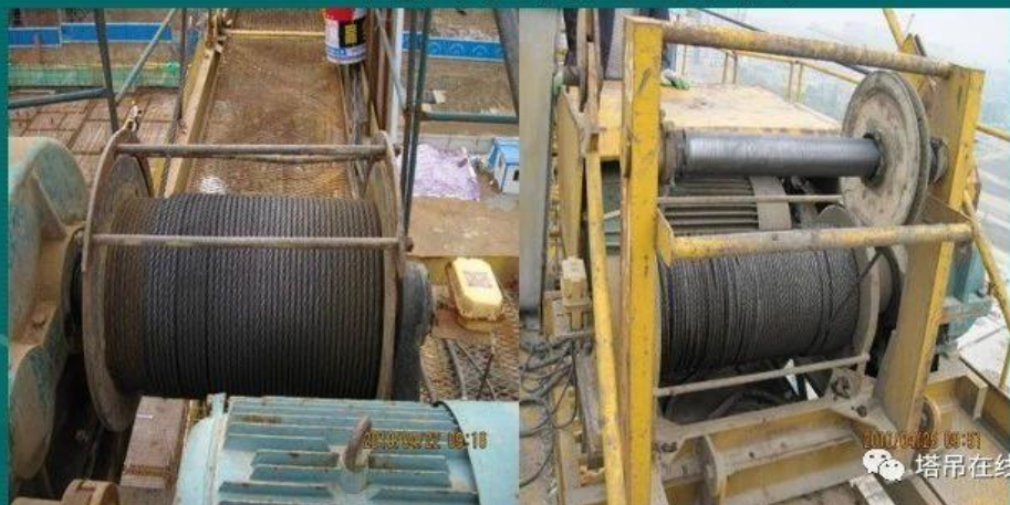
3.7.2 起升机构隐患图片
