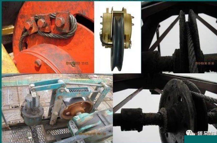
3.7.2 起升机构隐患图片
