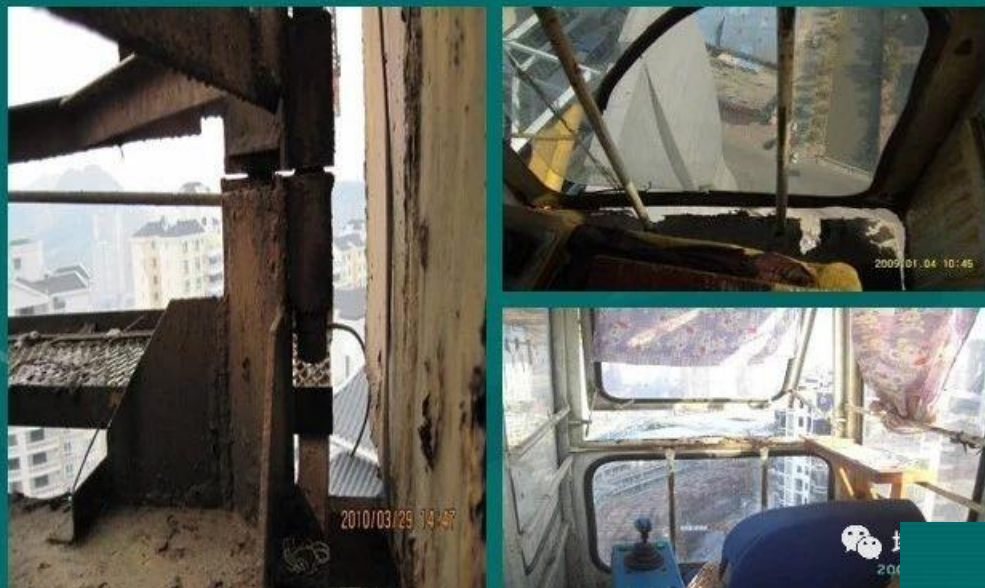
3.5.2 塔帽及驾驶室隐患图片
